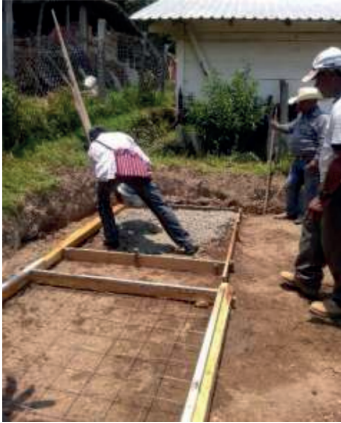
Figura 4. Medidas, armado y colocación de la malla dentro de la cimbra Figura 4. Medidas, armado y colocación de la malla dentro de la cimbra
