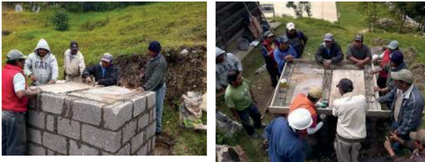
Figura 15. Construcción la cimbra sobre las cámaras e instalación de PVC para gases.
